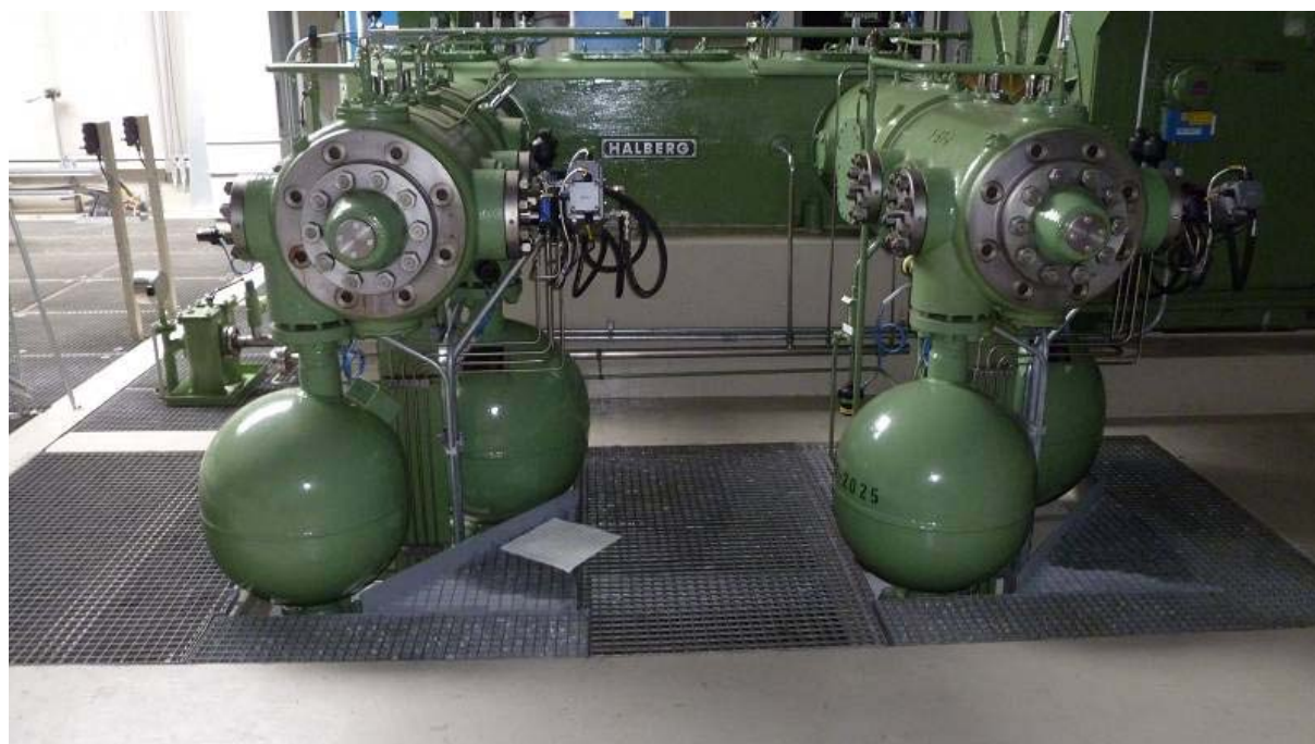
Abbildung 2.2: Kolbenverdichter K-201 im Originalzustand mit kugelförmigen Pulsationsdämpfern.
