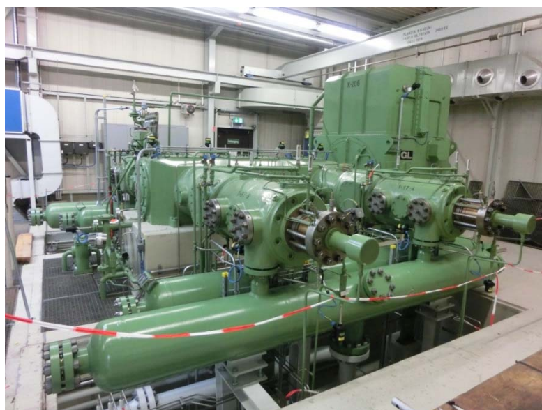
Abbildung 5.1: Verdichter K-205 nach Montage der neuen Pulsationsdämpfer, Blick auf die Zylinder der 1. Stufe.
